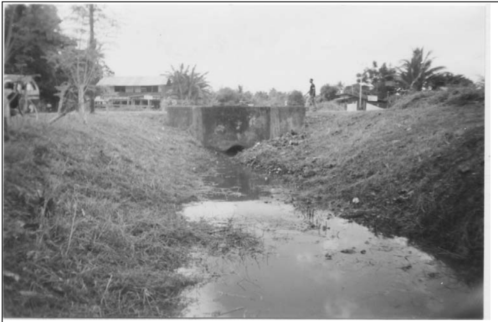
Gambar 3.20. Pendangkalan saluran drainase disebabkan sampah maupun tumpukan sedimen dari tepi bangunan drainase (dok. Dinas PDLPE, 2006)
