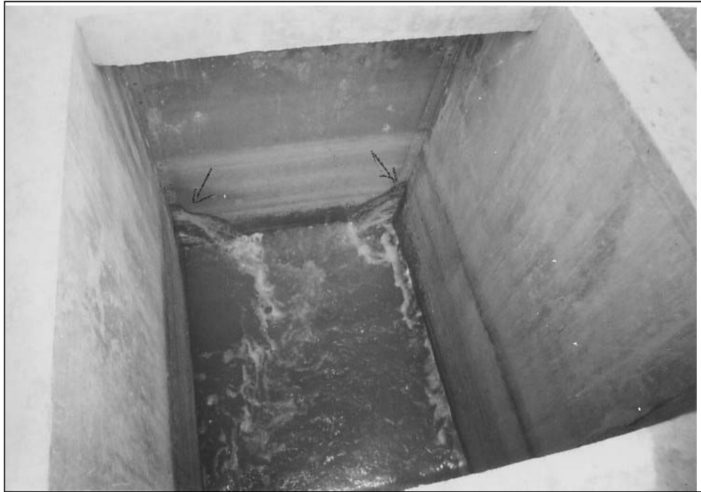
Gambar 3.16. Pintu air yang tidak lagi berfungsi baik (Sumber DPU Merauke, 2006)
